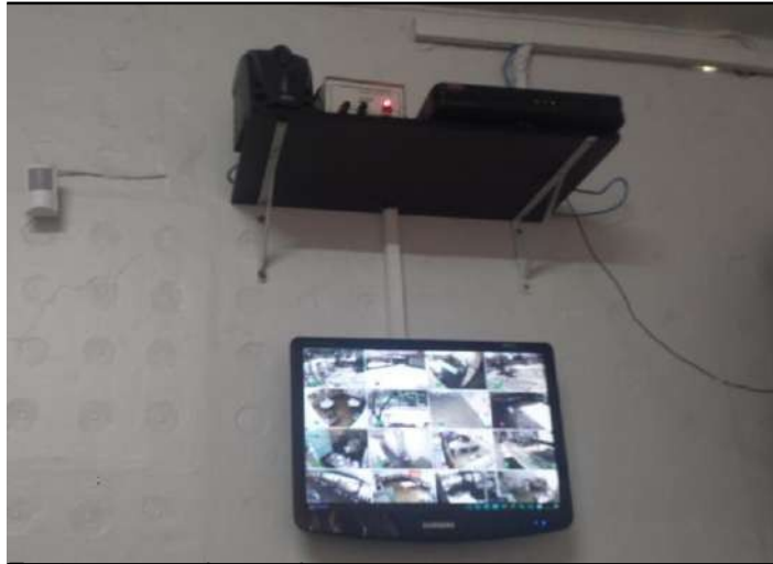
Foto 43 – Equipamento de monitoramento
